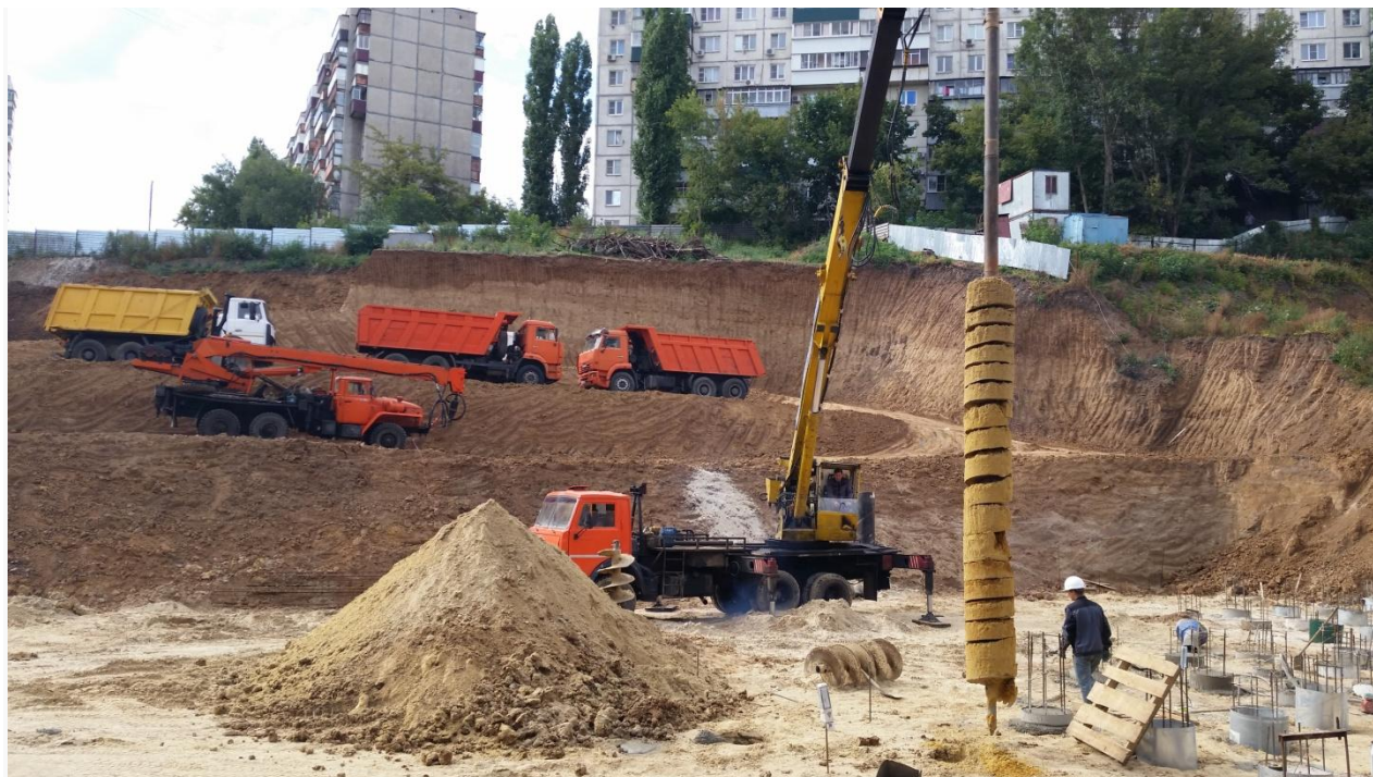
Устройство буронабивных свай под защитой обсадной трубы диаметром 630 мм, глубиной до 12 м, в г. Липецк, ул. Нижняя Логовая.
